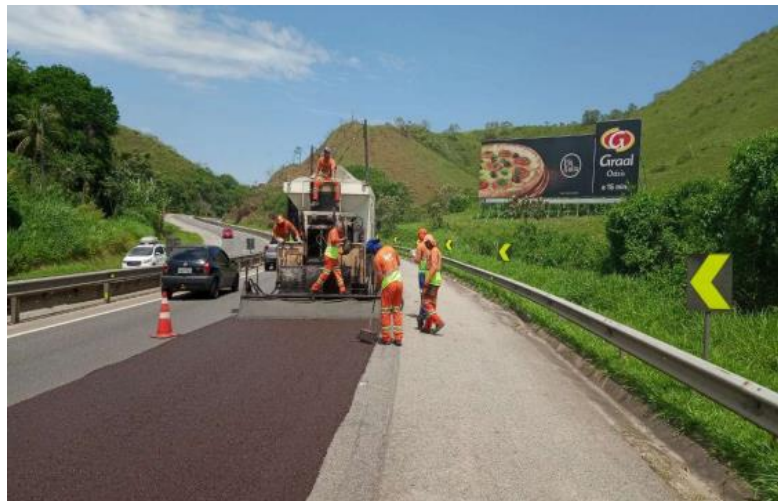
Figura 6.11 Via Lagos – Micro revestimento - Km 02+000 Norte
