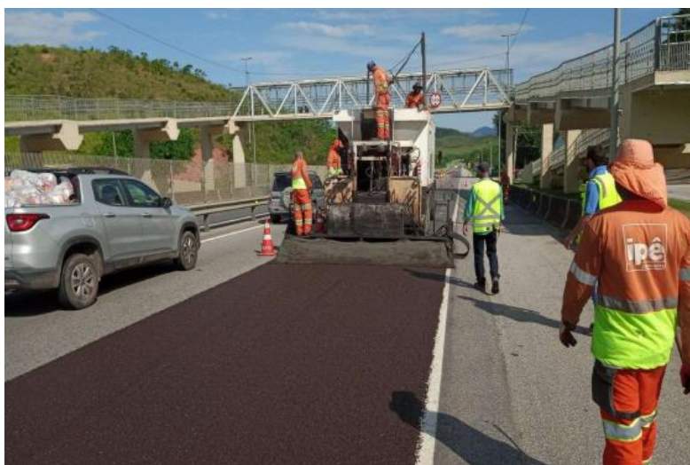
Figura 6.13 Via Lagos – Micro revestimento - Km 3+300 Norte
