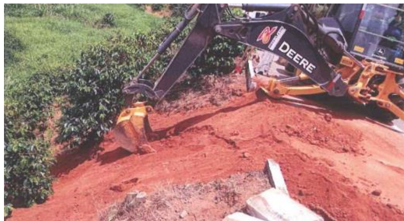
Figura 6.23 Rota 116 – Recuperação de área degradada – km 108.2 Norte
